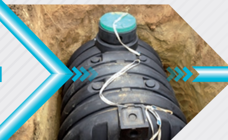
Cuve de récupération d'eau
